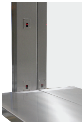
Detalhe do photocell do guichê automático
